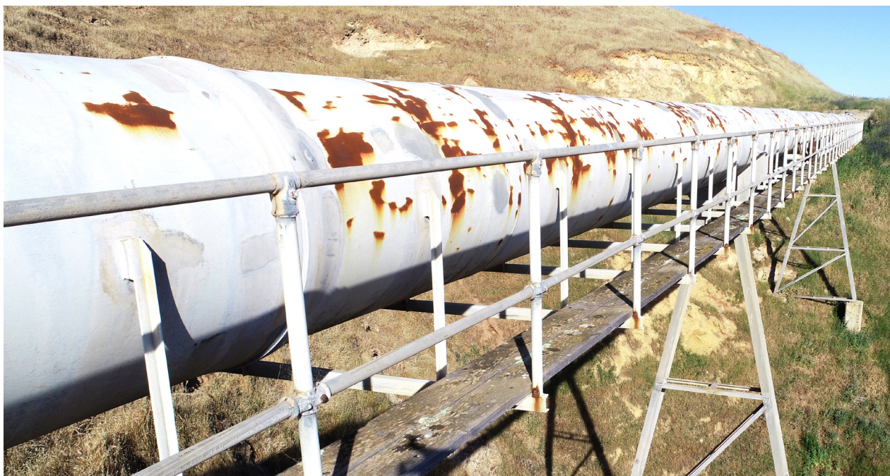
Corrosão e danos causados pela idade deterioram as tubulações e aumentam a probabilidade de ocorrência de rupturas.
